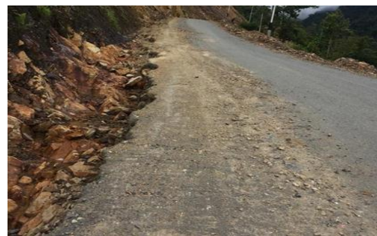
Gambar 4. Retak Pinggir Perkerasan
