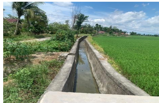
Gambar 3. Kondisi Drainase Desa Cenning
