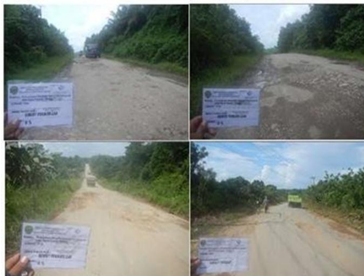
Gambar 2. Kondisi Ruas Jalan Samboja – Petung
